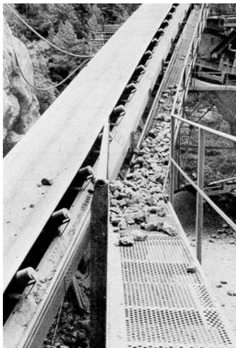
Foto 4: Pasarela de visita adosada a la cinta transportadora primaria. Sobre la pasarela puede observarse la acumulación de fragmentos de granulometría gruesa, debido a un derrame.
